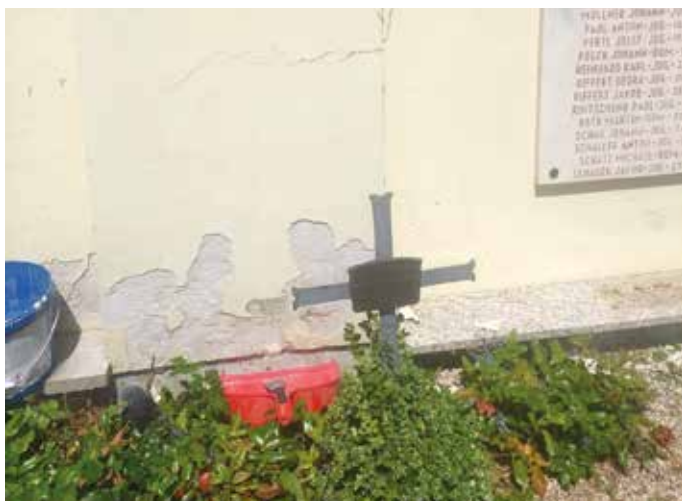
Schäden an der Friedhofsmauer in der Sektion V des Kommunalfriedhofes Ansfelden
