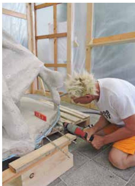
Neben der ästhetischen Wirkung sollen die Ergänzungen auch die Standsicherheit der Skulptur verbessern.
